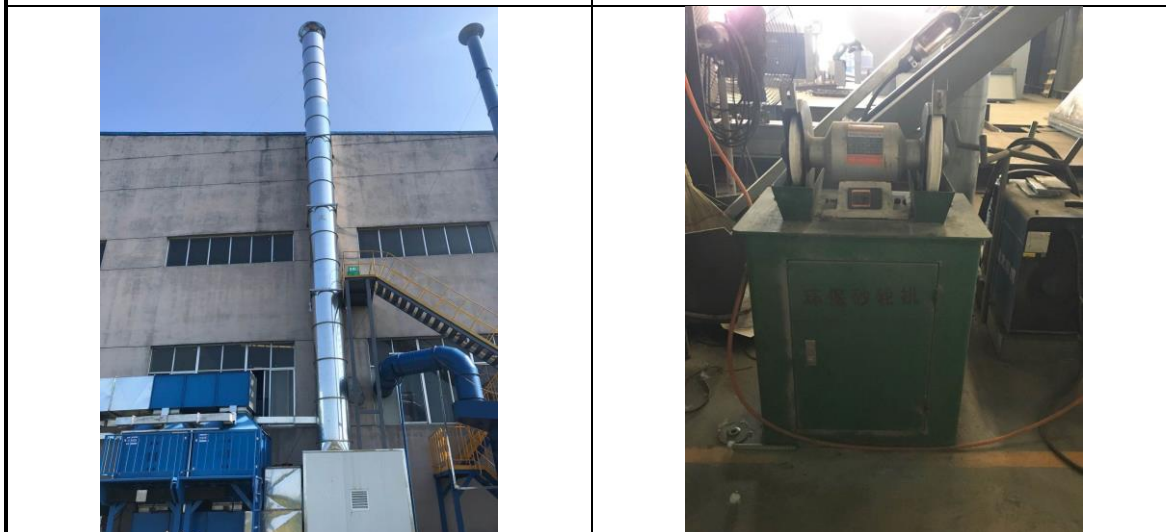
喷漆房配套排气筒
