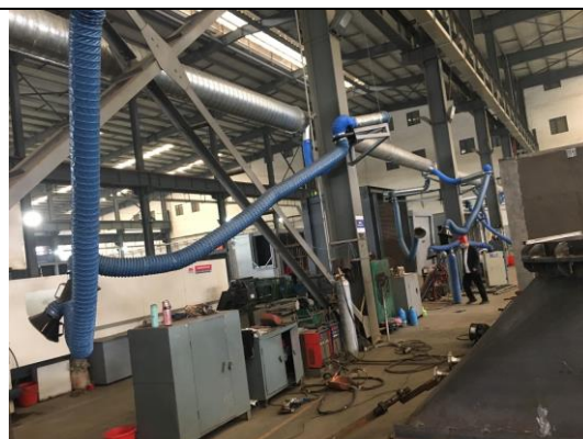
集中焊接区烟尘收集装置
