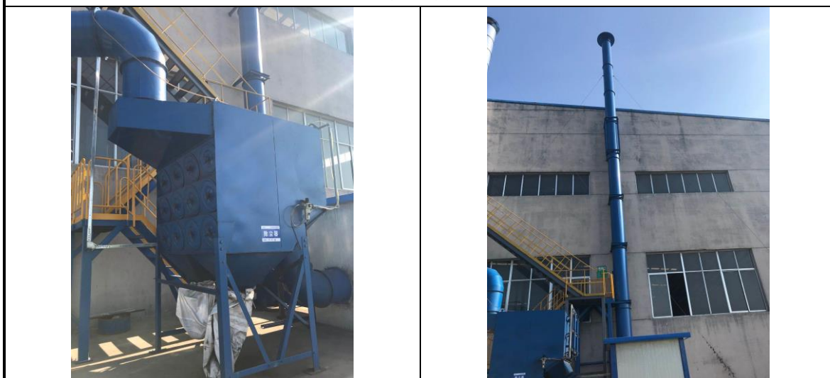
喷砂房配套滤筒除尘器+排气筒
