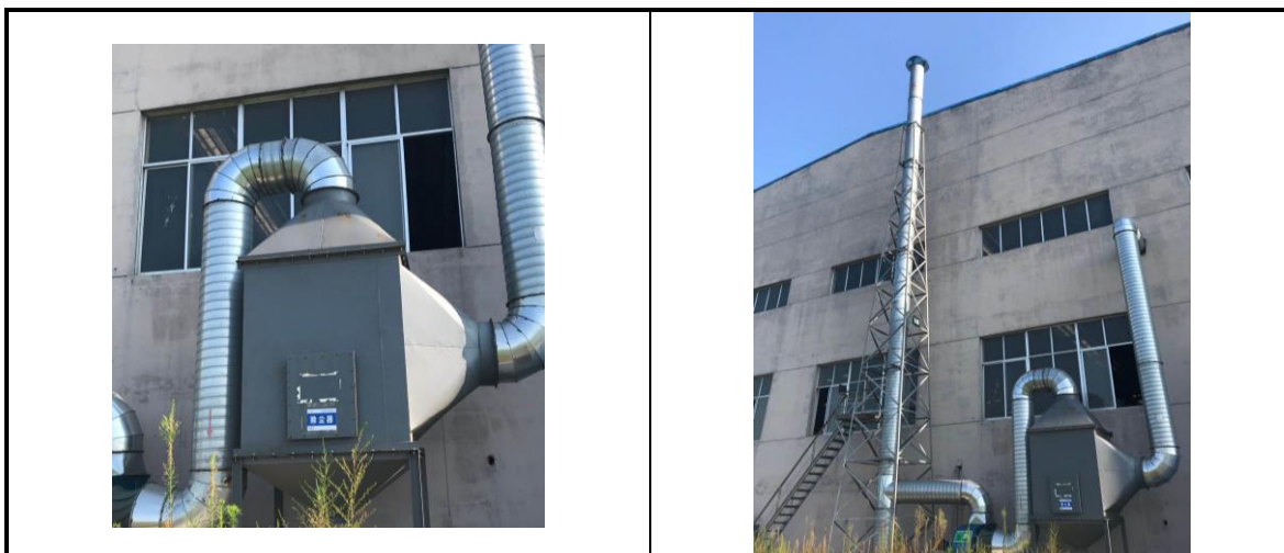
集中焊接区配套滤筒除尘器+排气筒
