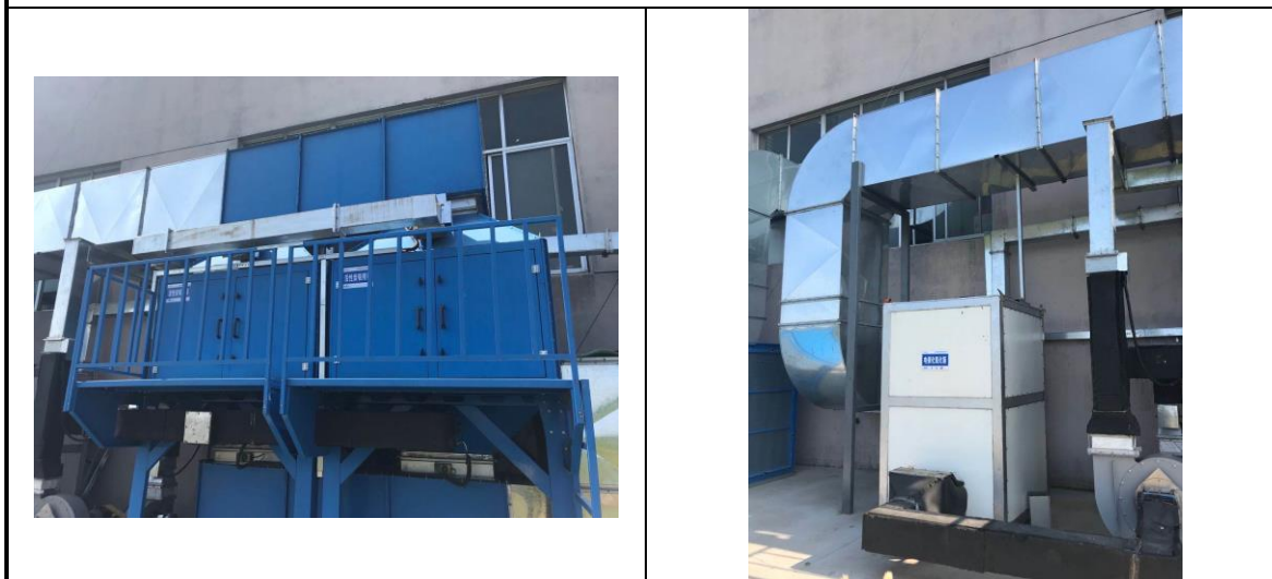
喷漆房配套活性炭吸附装置
